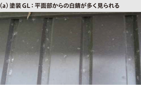
（a）塗装GL：平面部からの白錆が多く見られる
